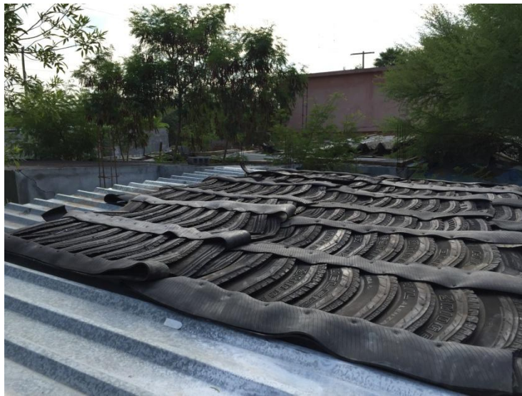
Figura 12.- Aislamiento térmico en techos
